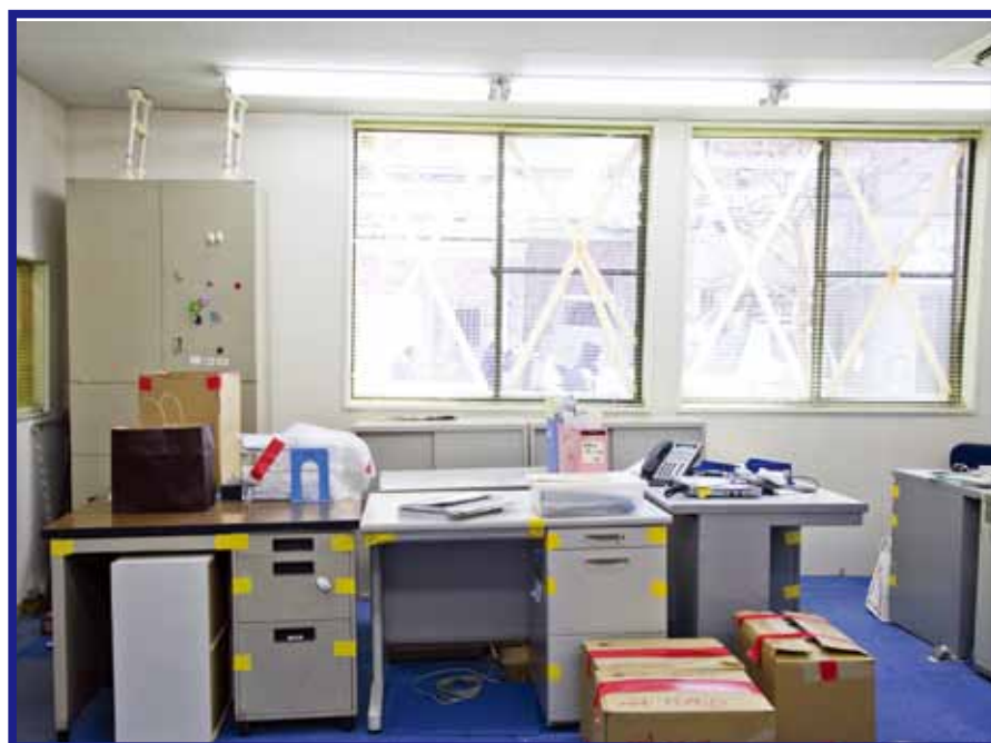
建物が歪んだため、机が傾き、窓が変形しました 天井や床の境目に壁紙の剥がれが発生しています (本部)
