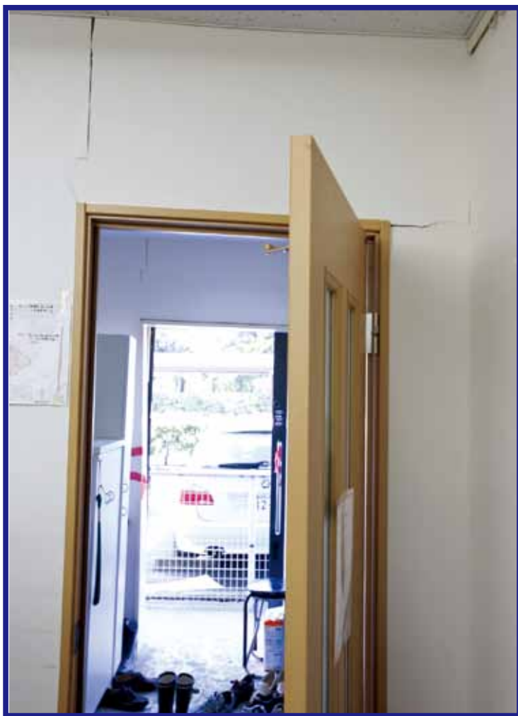
天井からひび割れが入り、 ドアは斜めに曲がっています
