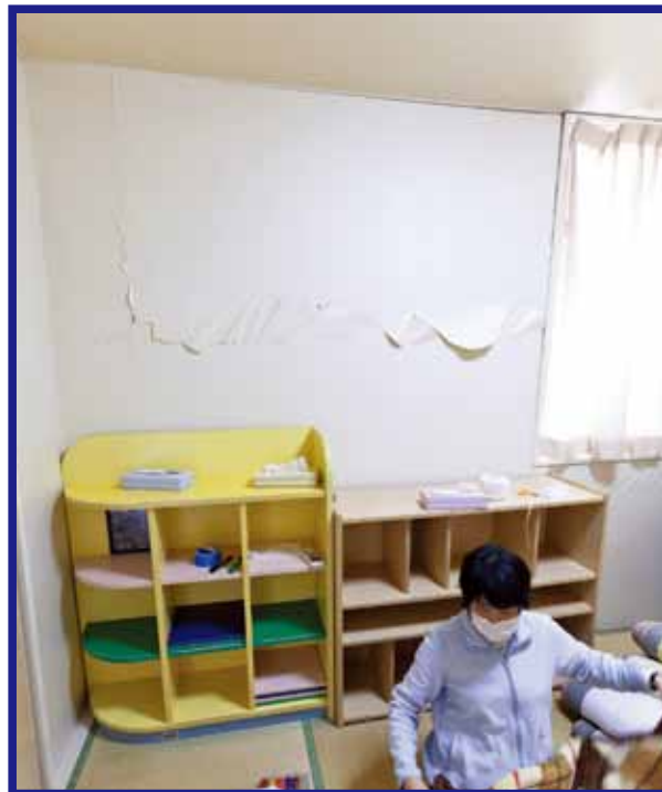
壁がずれ、壁紙が剥がれたケアルーム
