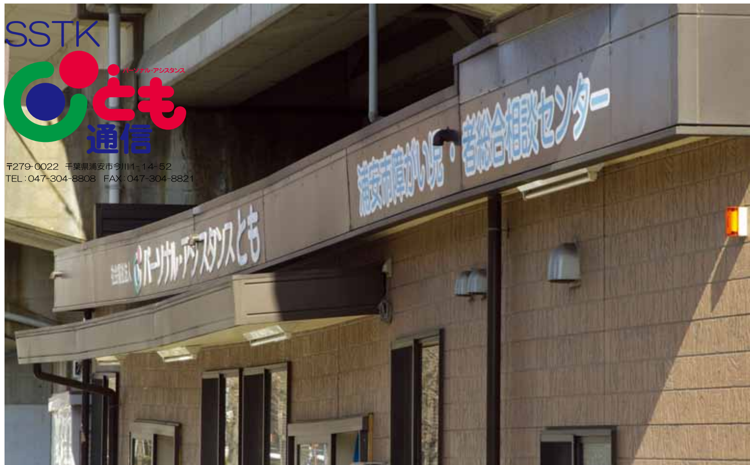
本部の躯体の中央が地盤沈下し、建物が歪んだため屋根が波うっています
